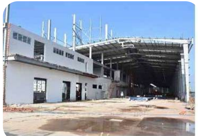
Nhà máy MDF Chơn Thành CHON THANH MDF FACTORY
